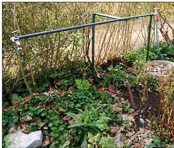
Vandpost med to haner.
